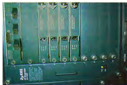
Оборудование, обеспечивающее выход в Сеть в селе Пестрецы
